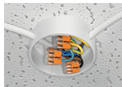
天花板吊顶照明配电
